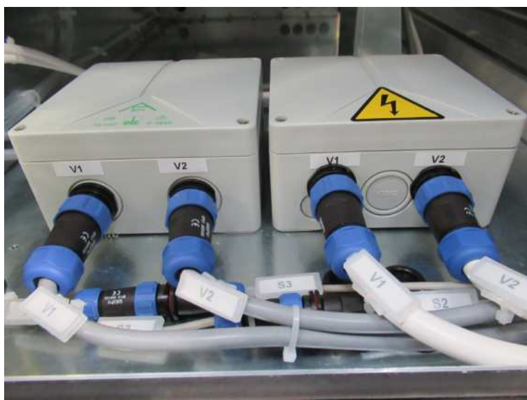
provedení konektorů na hranici 2. a 3. transportního bloku – – napájení ventilátorů přívodu, odvodu a teplotních čidel v bloku č. 3
