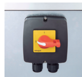
svorkovnice s revizním vypínačem
