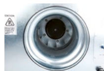
zvuková izolace na sání ventilátoru
