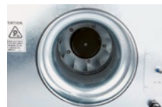
zvuková izolace na sání ventilátoru
